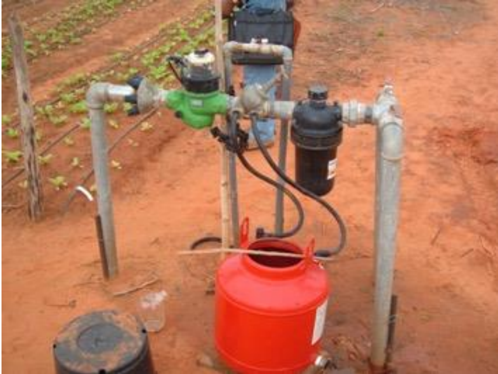
Image 3 : Eléments de régulation, filtrage et fertigation
